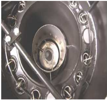
Limpieza automática de caldera
